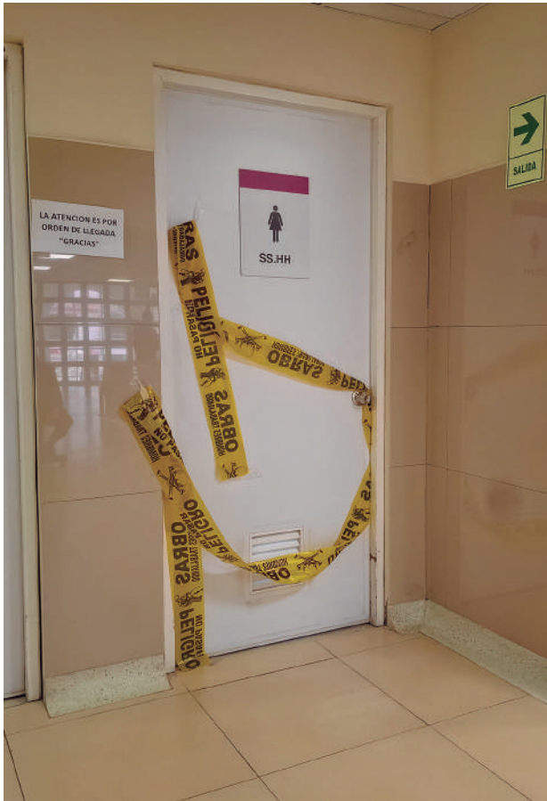
Servicios higiénicos clausurados y en mal estado.
